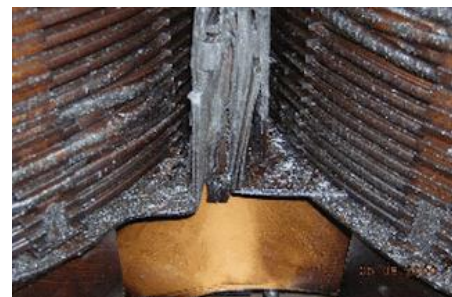
Fig. 6. Falla a tierra del dieléctrico de un transformador.
