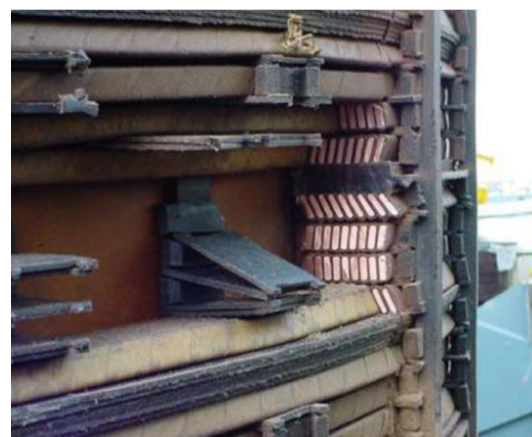
Fig. 2. Falla por aplastamiento debido a fuerzas axiales en un transformador
