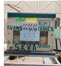
Fig. 10. Bornes de conexión y caja para la activación de las fallas.
