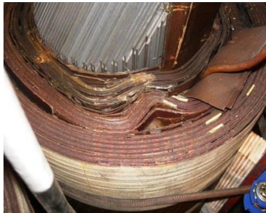
Fig. 3. Deformación radial del devanado secundario en un transformador.
