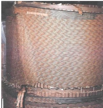
Fig. 4. Pandeo del devanado primario de un transformador de potencia.
