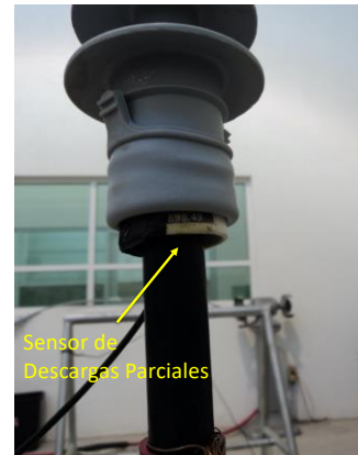
Fig. 6. Colocación del sensor en el cuerpo de la terminal con falla.
